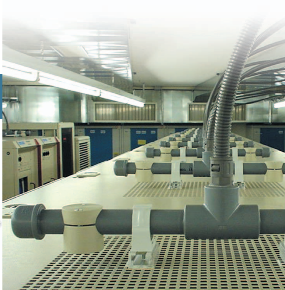
Typische Überwachung eines EDV-Rechners mittels eines Fühler-Rohrnetzes (Bildquelle: Securiton)
