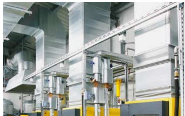
Abluftkanal zum Heizen benachbarter Räume
